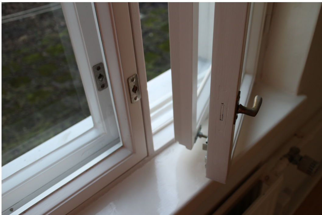
1950-luvun ikkunan tuuletusikkunan puitteet on kunnostamisen yhteydessä kytketty toisiinsa ja varustettu aukeamisrajoittimin.
