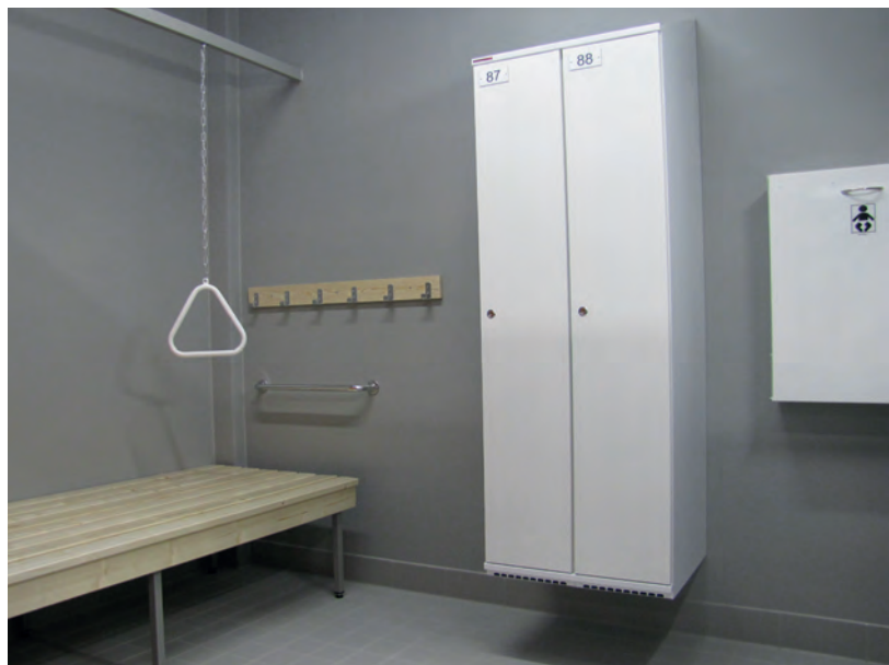
Tillgängligt omklädningsrum med omklädningsbänk och stödräcken.
