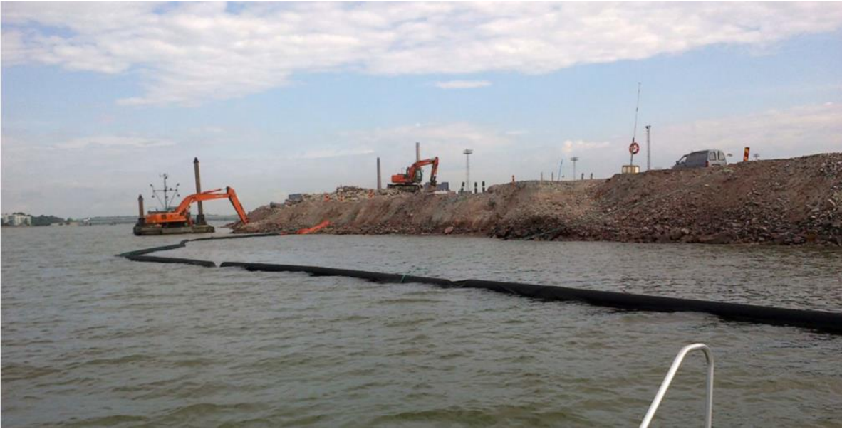
Kuva 24: Meritäytön suojaverho käytössä Jätkäsaarella (Ramboll Finland Oy, 2016).
