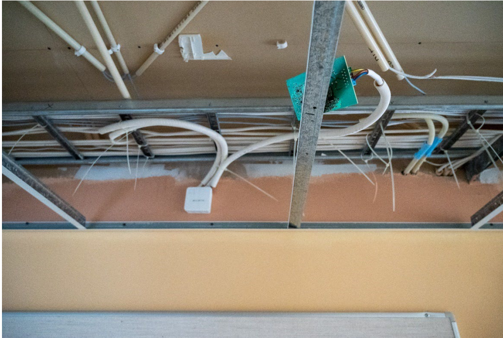
Kuva 10. Sähköjohtimia ja asennustarvikkeita purettavan rakennuksen alaslasketussa katossa Tasanteen päiväkodillä. (Tuomas Laitinen 2022.)
