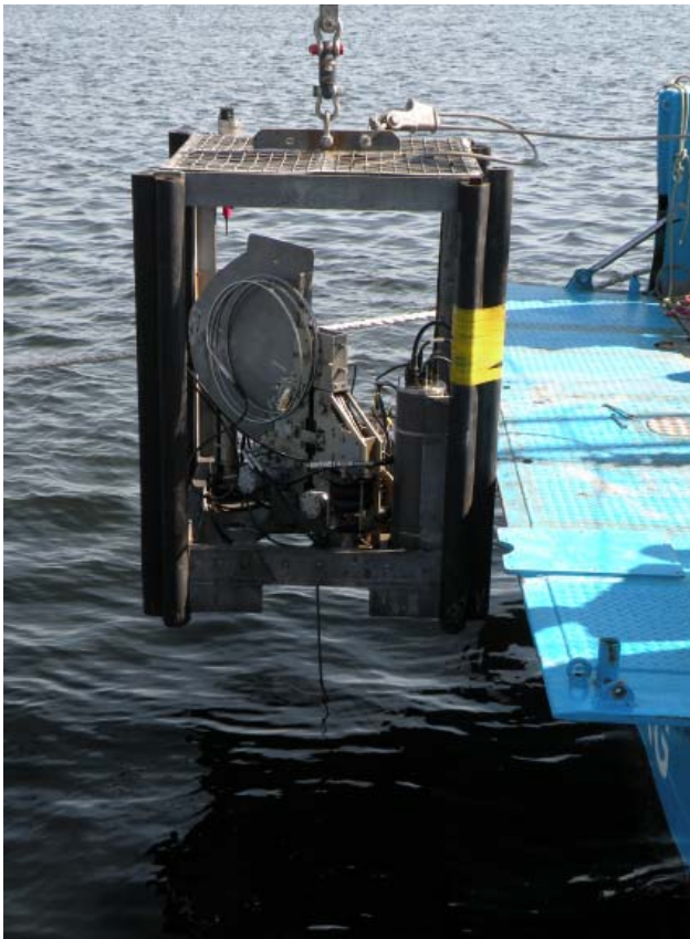
Geotekniska undersökningar på Södra Midsjöbanken, 2011; Bilden visar CPT utrustning (Cone Penetration Test) som används för bestämning av jordlagerföljd och egenskaper i jord.
